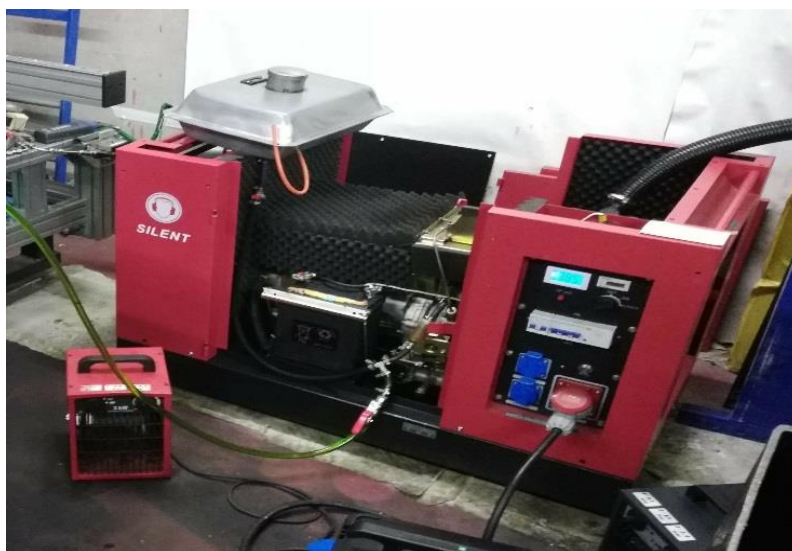
Figuur 10 Opstelling generator
